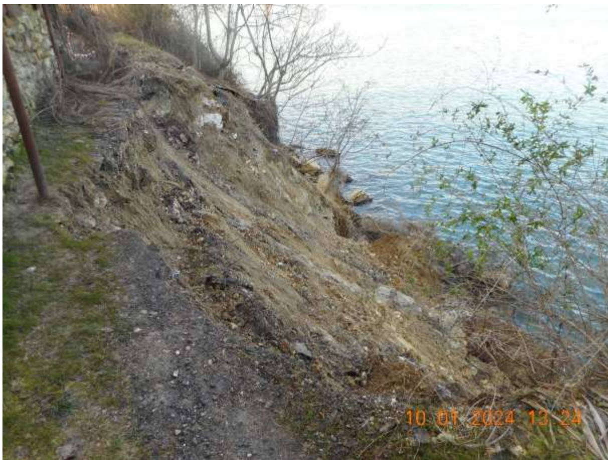
Рис. 2.7 Обрушение пешеходной тропы.
