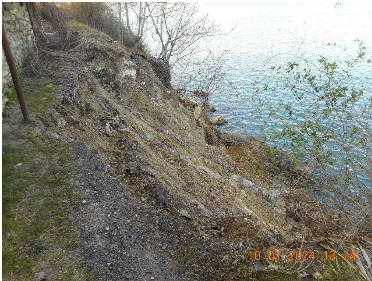
Рис. 2.7 Обрушение пешеходной тропы.
