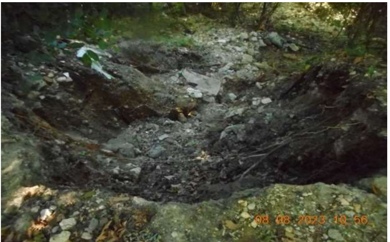
Рис. 2.32 Провал грунта в районе детской площадки по ул. Адм. Макарова, д. 13
