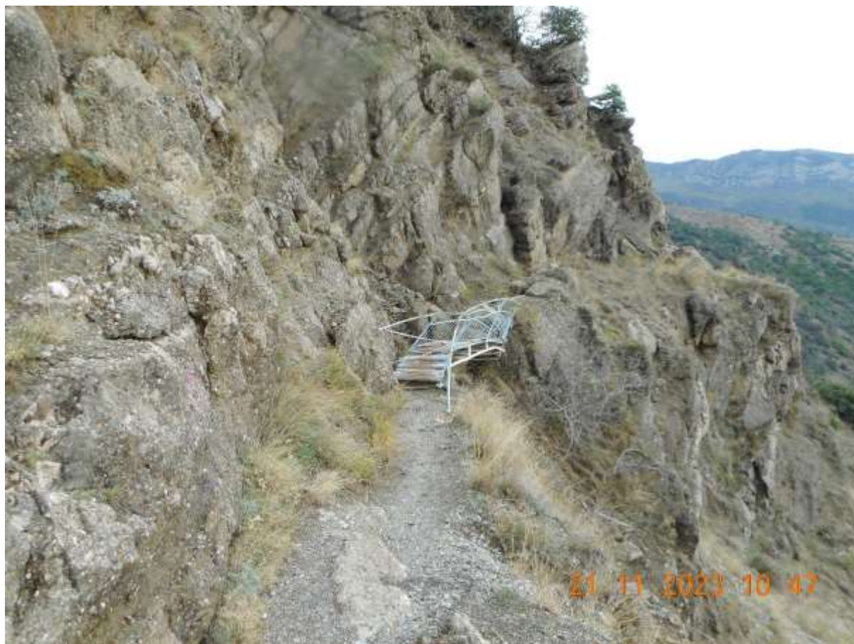
Рис. 2.34 Деформация пешеходного мостика в результате обвала
