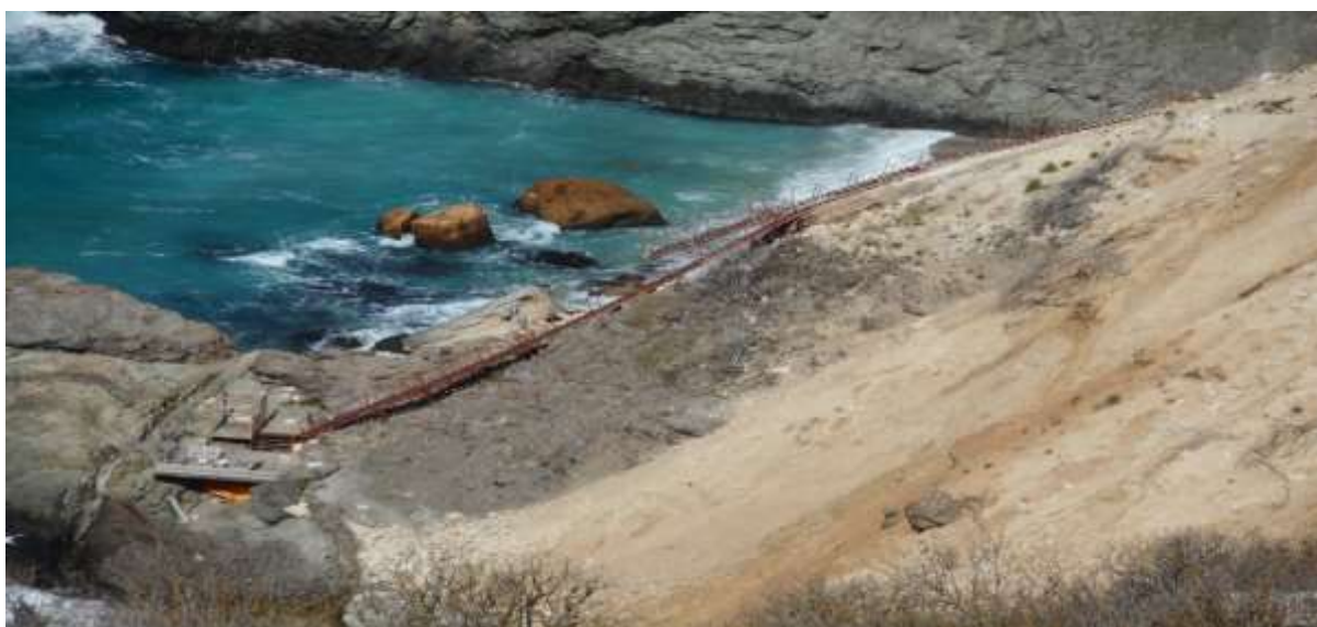
Рис. 2.22 Повреждение металлической лестницы на пляж «Царское село»
