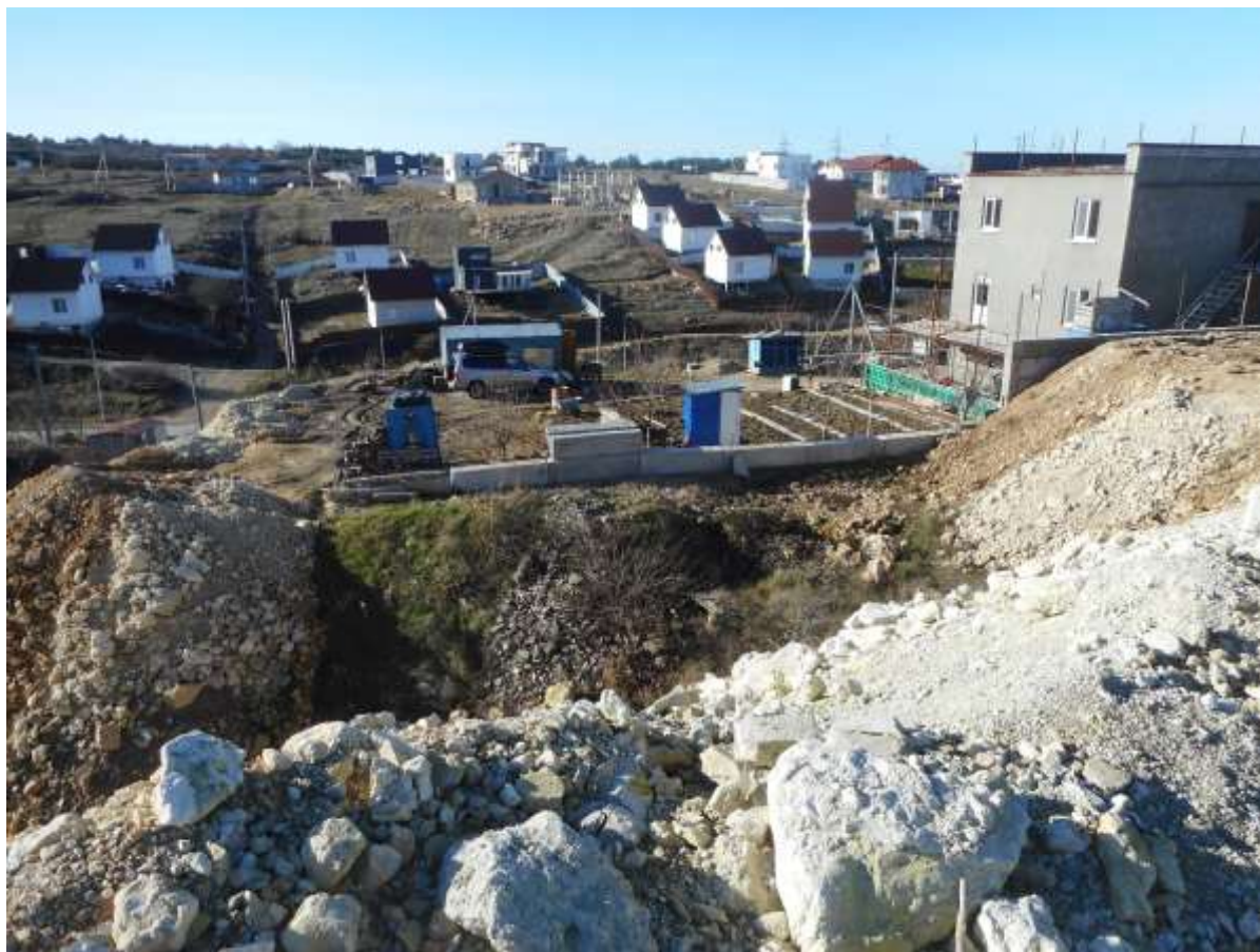
Рис. 2.17 Складирование грунта и строительного мусора на склоне
