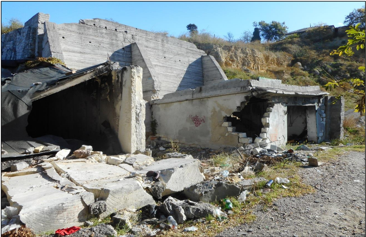
Рис. 2.7. Полуразрушенные гаражи в средней части оползня. Подпорная стена потеряла свои удерживающие свойства. IV квартал 2021 г. (№ 67-1110-0004)
