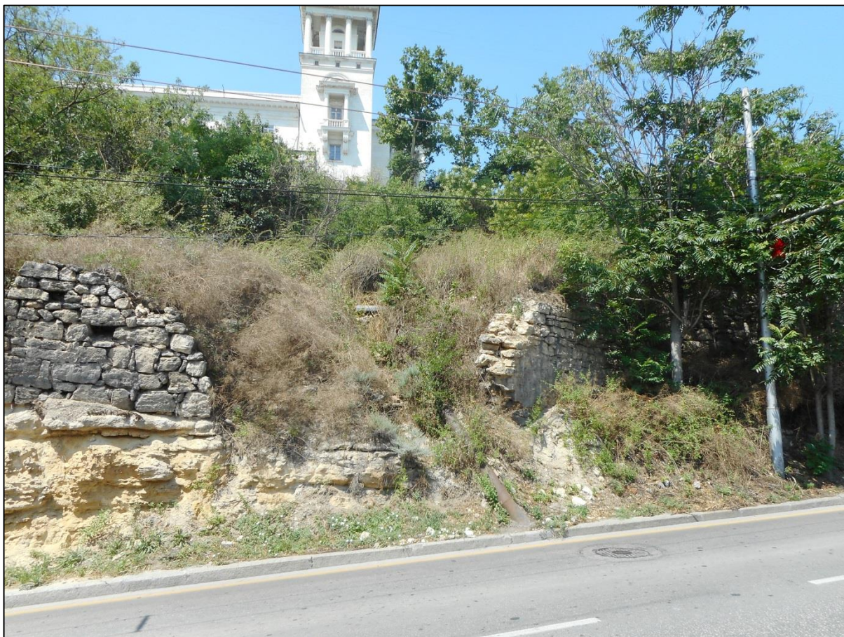
Рис. 2.8. Красный спуск. Разрушающаяся подпорная стена ниже Матросского клуба. Развитие эрозии, обсыпание грунта, проседание горных пород. III квартал 2021 г. (№ 67-1110-0005)
