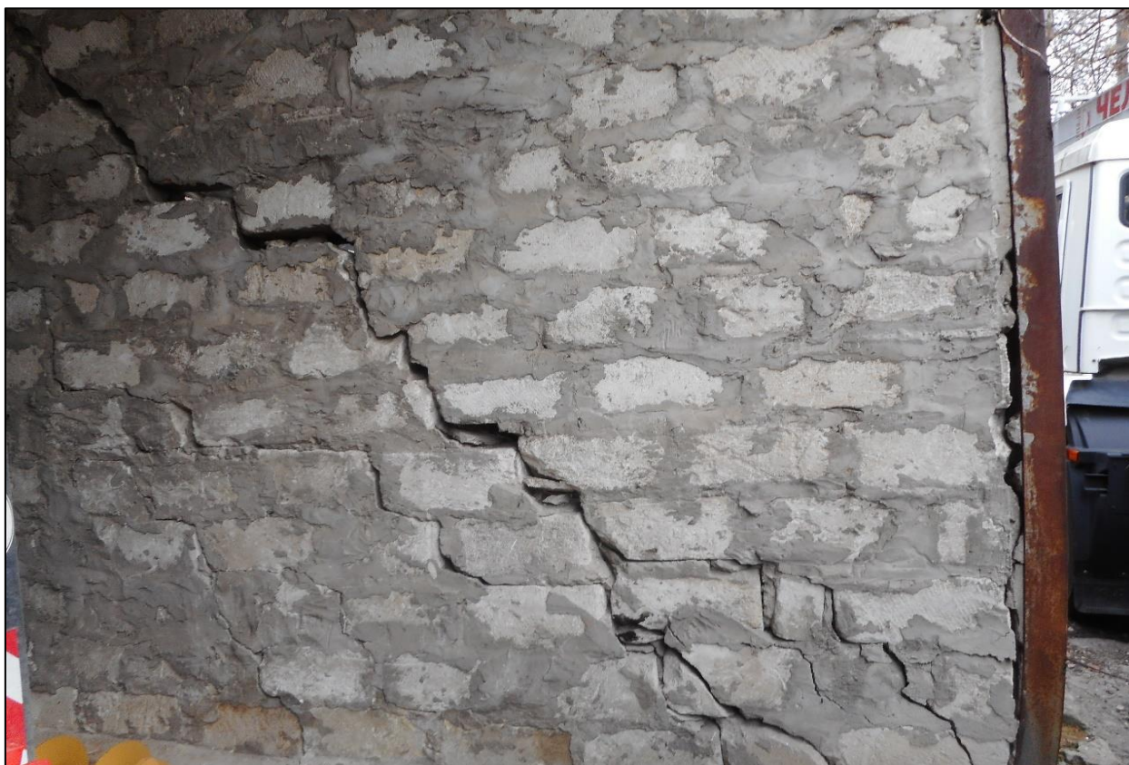
Рис. 2.15. Деформации стен строений предприятия «Горсвет» (13.12.2021 г.)
