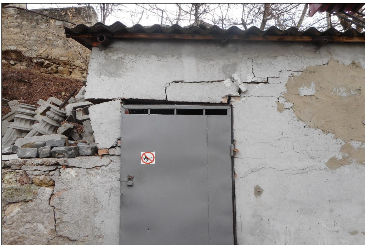
Рис. 2.16. Юго-восточная часть территории «Горсвет», старые деформации на строении (13.12.2021 г.)
