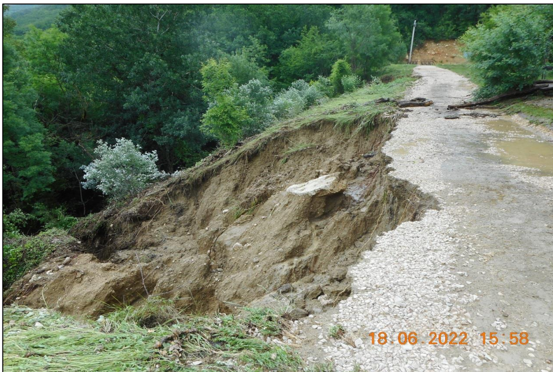
Рис. 2.19. Торопова дача. Размыв гребня плотины. Оползневые откосы с внешней стороны плотины. Промоина шириной 12 м, глубина срыва 4 м. (18.06.2021 г.)
