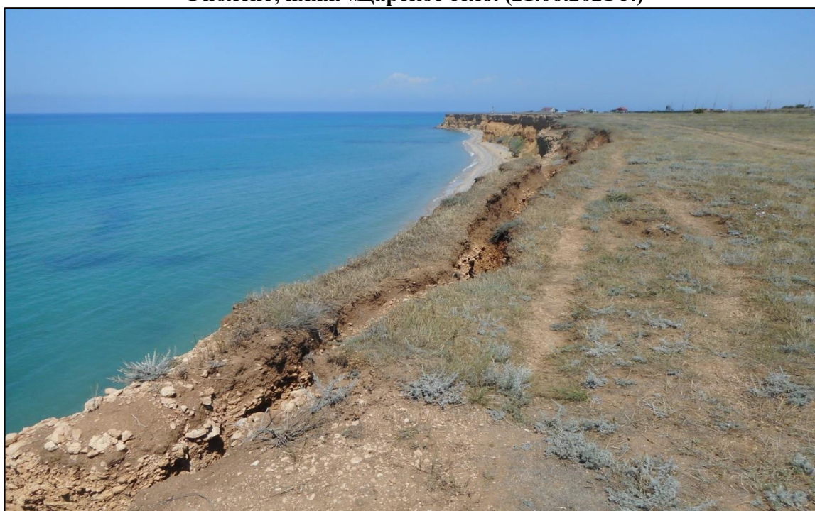
Рис. 2.18. Обвалоопасный клиф на протяжении 750м, заколы блоков длинной вдоль бровки до 30 м, шириной до 1 м. п. Кача, Матросский пляж. (26.06.2021 г.)
